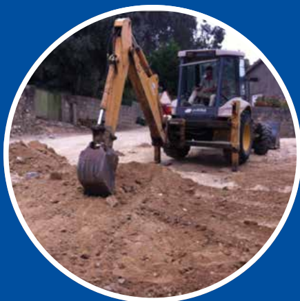
Pavimentação da Rua de Nossa Sra das Neves e Rua de Corvos Bagunte
